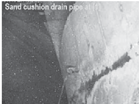
第3図 1号機PCV下部サンドクッションドレン管からの水の漏えい状況
