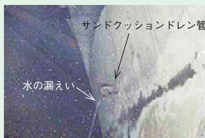
1号機PCV下部サンドクッションドレン管からの水の漏えい状況
