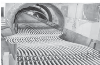
第3図 蒸気発生器内の配管
