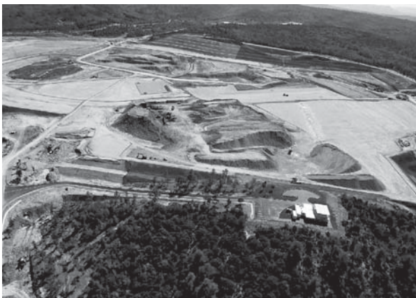
第2図 南仏カダラッシュのITER建設現場 (写真はITER機構の提供)
