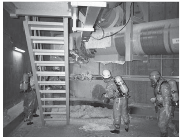
第4図 ナトリウム漏えい現場状況
