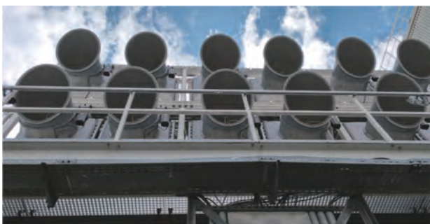
大気中のCO 2 を回収するClimeworks社のDAC設備
