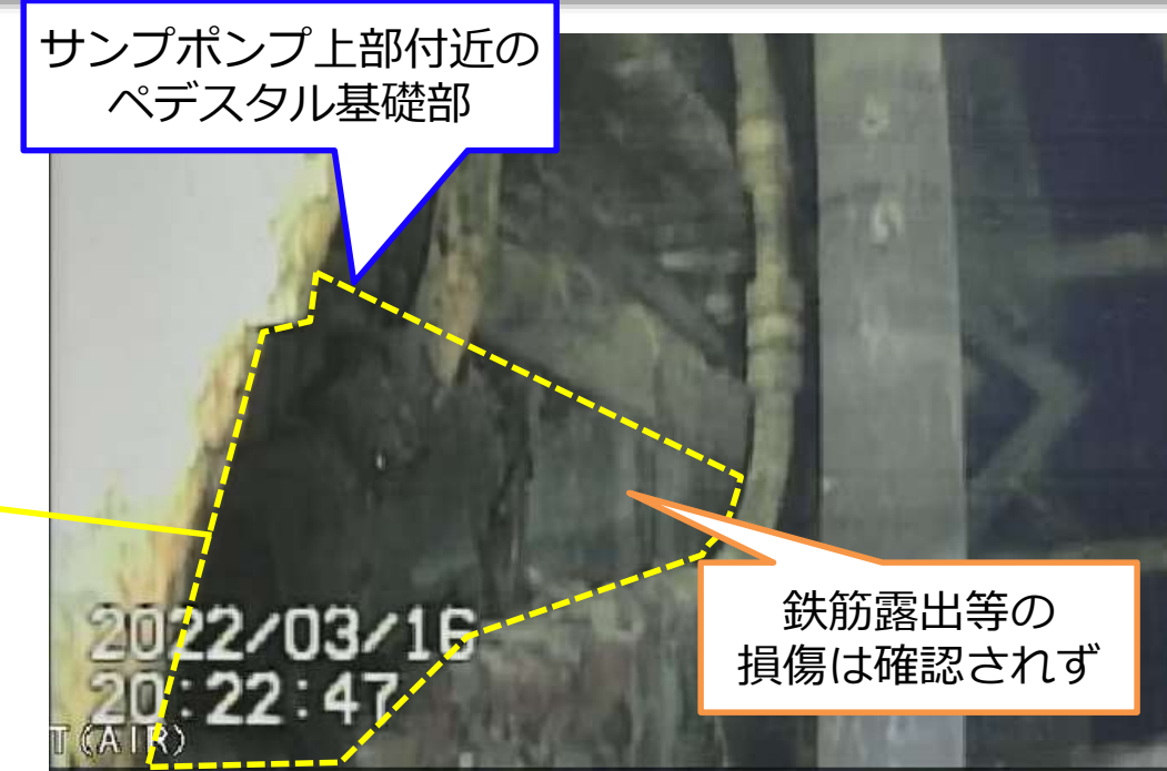
写真5. 遮へい板裏ペDESTAL壁面(堆積物上部)
