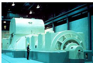
発電所で使われていた発電機 (写真)
