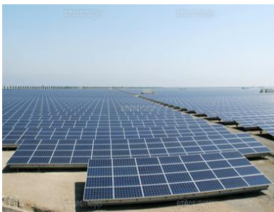
大規模太陽光発電所（写真） （愛媛県松山市）
