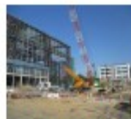
モックアップ試験施設 (樹業遠隔技術開発センター) 遠隔操作機器の開発・実証(除染、観察、補修)等を実施
