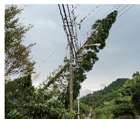
樹木倒壊の例 (2019年台風15号)
