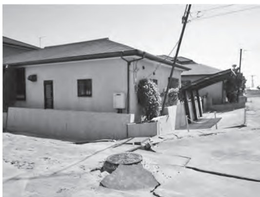
写真1 茨城県で液状化を被災した住宅
