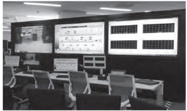
写真4 CSSC 訓練用プラント運転卓模擬装置
