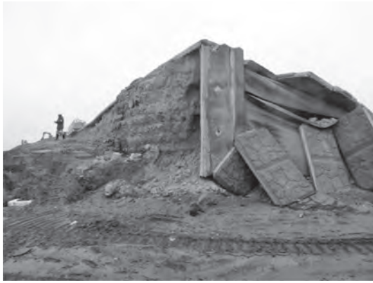
写真2 津波で流失した宮城県の海岸堤防残骸
