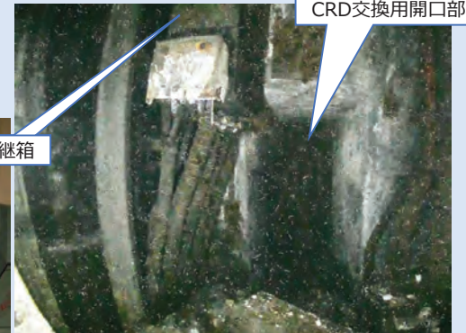
CRD交換用開口部前の状況(中継箱)
