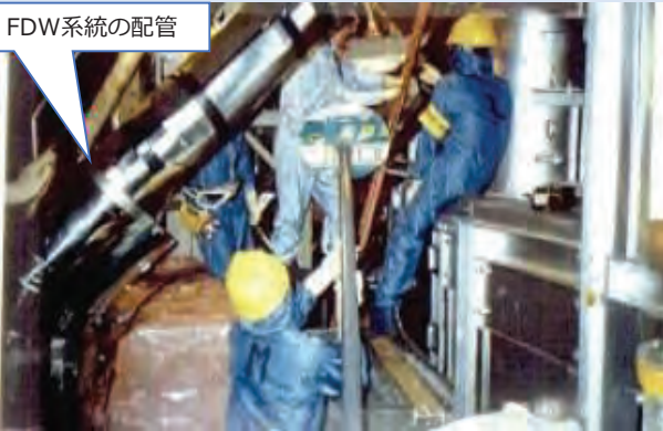
【震災前：定期検査時】FDW系統配管
