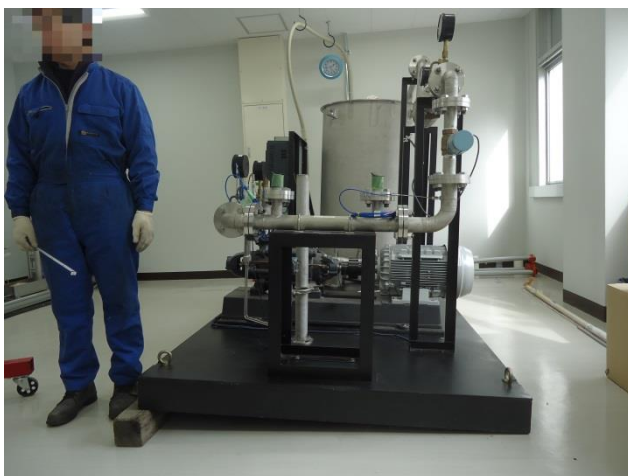
ポンプ設置状況写真
